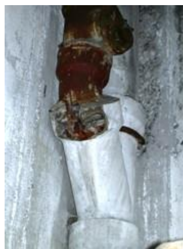
Ruptures de canalisation, fuites
